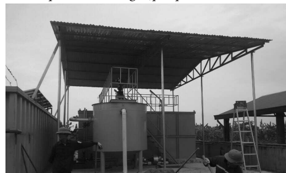
▲ Hệ pilot xử lý nước thải sinh hoạt và công nghiệp theo công nghệ mới DS-BB
